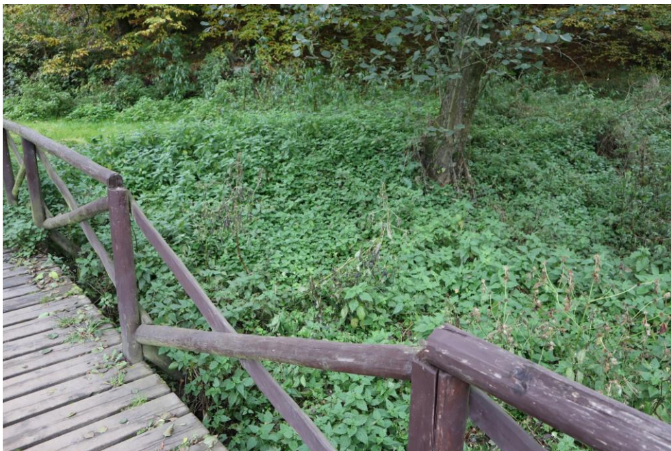
Ulomené zábradlí na lávce přes Mnichovku
