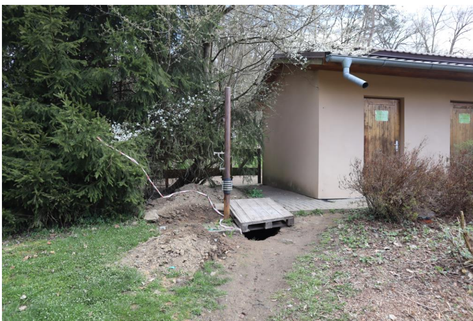
Provizorní oprava mrazem prasklé venkovní sprchy vysokotlakou spojkou
