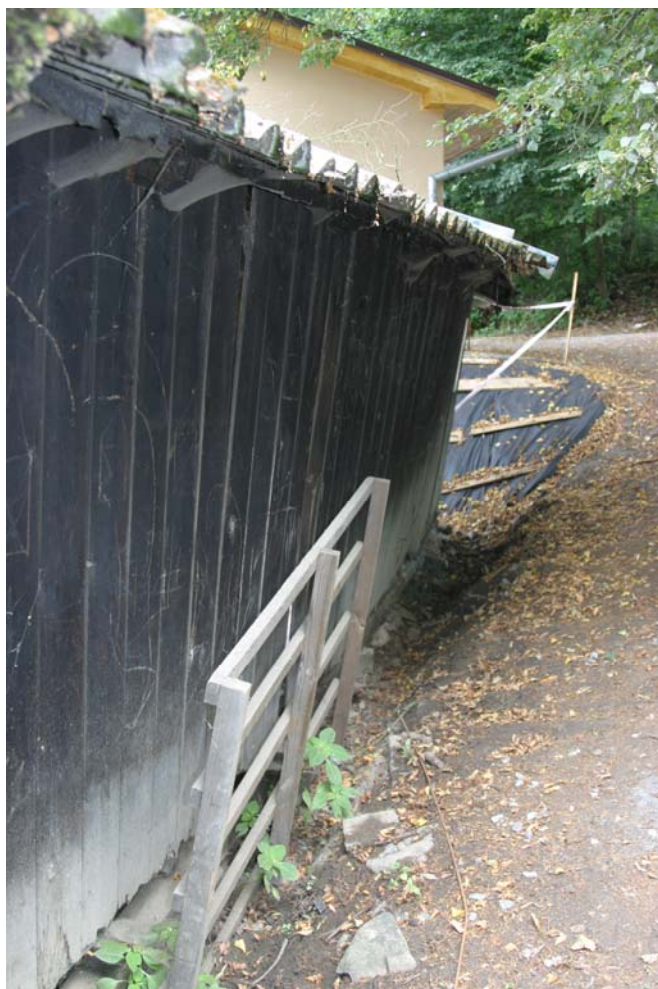
Vyhnutá zadní stěna kabin před opravou
