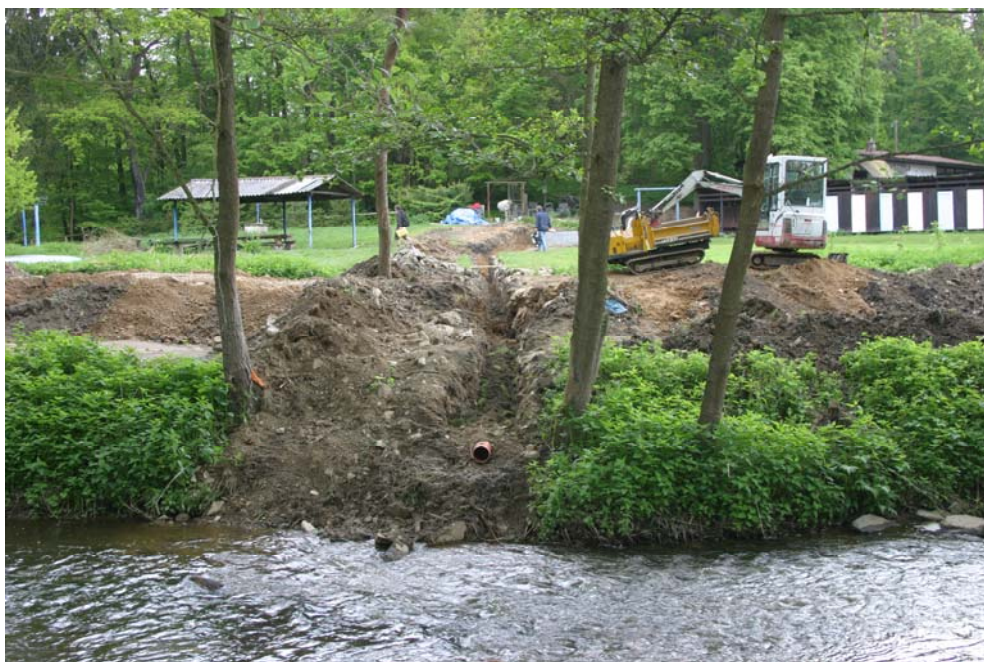
Vyústění kanalizačního řadu do Mnichovky
