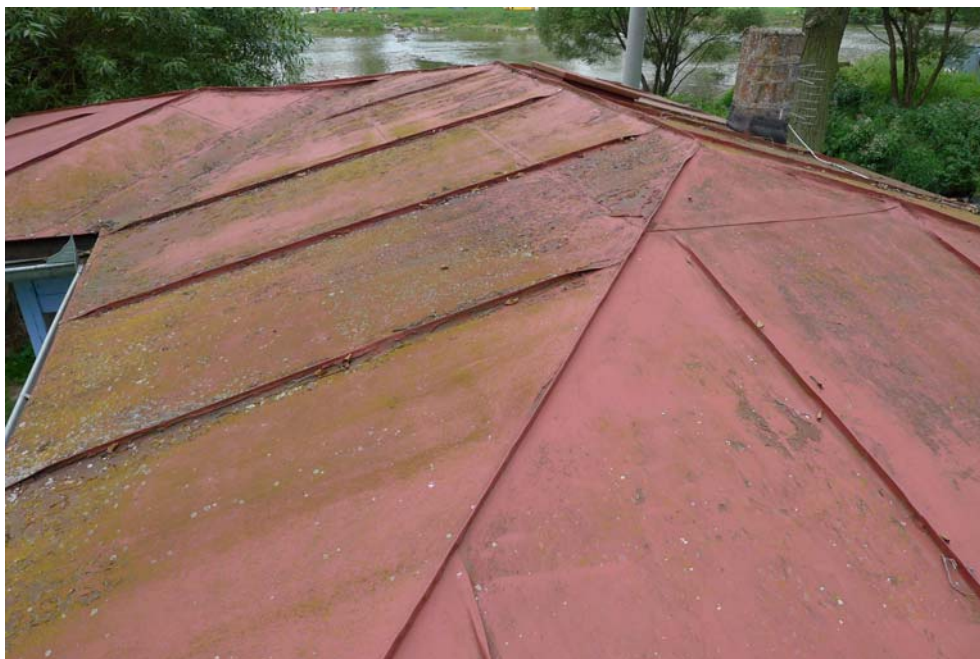
Špatný stav střechy převoznického domečku
